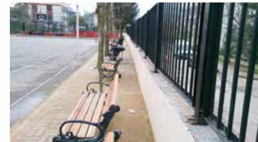
» A.Nihat Asya İlkokulu/Ortaokulu-Duvar,Korkuluk
