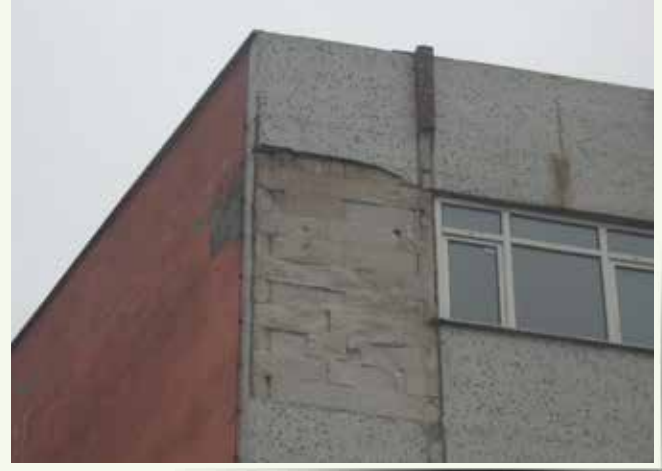
» Tehlike Oluşturan Bina Cepheleri Yenilenmektedir.
