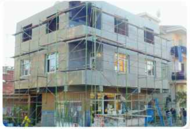
» Tehlike oluşturacak eski bina cepheleri yenilenmesi
