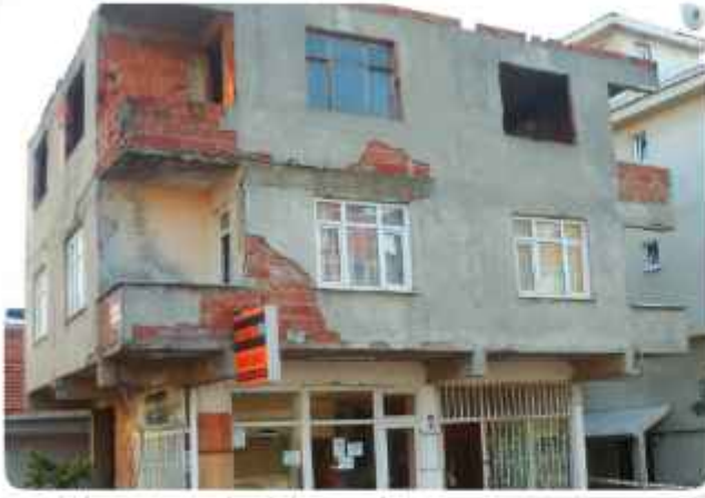
» Tehlike oluşturacak eski bina cepheleri yenilenmesi
