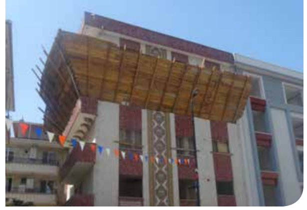
Risk oluşturan yapılar kentsel dönüşüm kapsamında yenilenmektedir.
