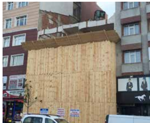
» Risk oluşturan yapılar kentsel dönüşüm kapsamında yenilenmektedir.
