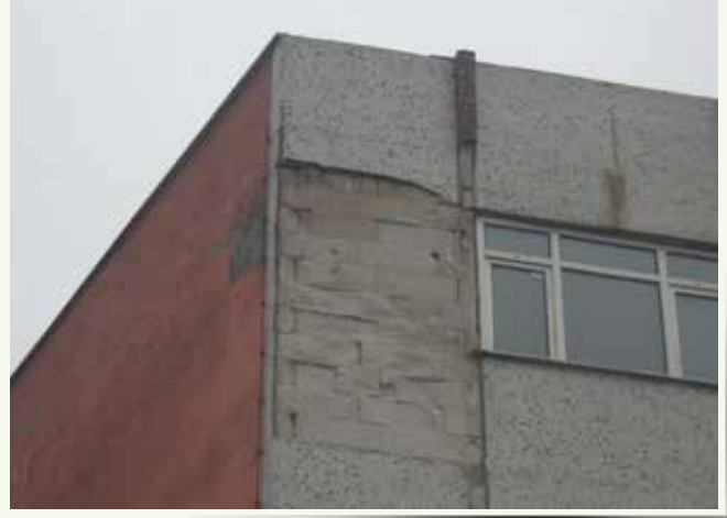
» Tehlike Oluşturan Bina Cepheleri Yenilenmektedir.
